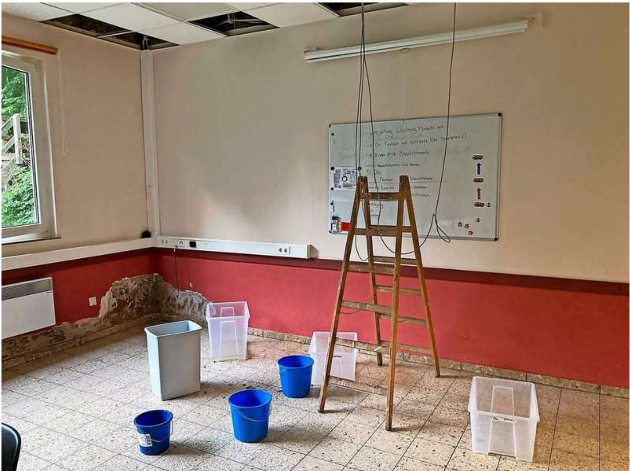
Schadensbegrenzung: Nach dem Wasserschaden ist der Sozialraum im Poller Feuerwehrhaus derzeit nicht nutzbar. Feuerwehr Polle
